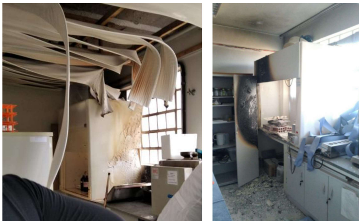
Imagem 1 - Registro após incêndio/explosão na edificação do CTA (a) e do CMETL (b)
