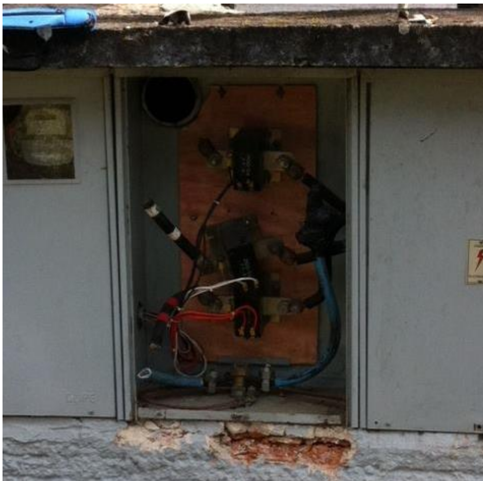
Figura 21 – Rede elétrica alvo de roubo Fonte: São Bento Motor Clube
