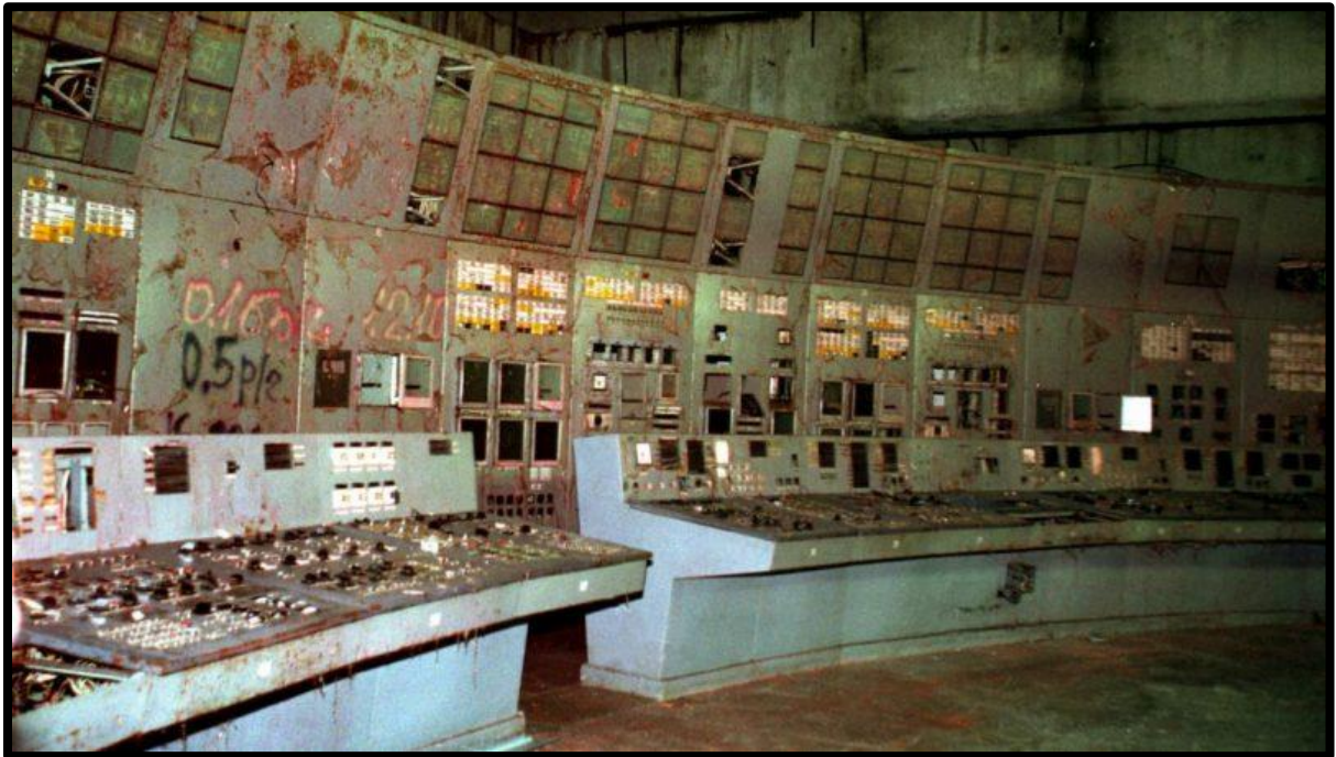
Figura 6 - Sala de controle do Reator 4
