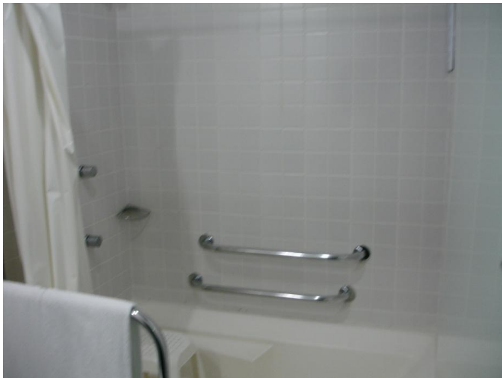
Foto 17 - Barra de apoio na banheira
