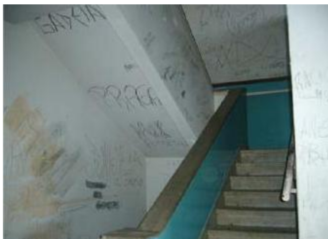
FIGURA 11 – Depredações dentro do Casarão 2 – Fonte Plano Diretor do Parque Cambuí - 2006
