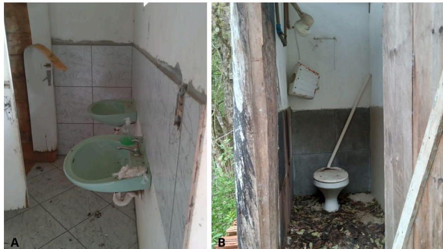
FIGURA 13 - (a) Banheiros da sede; (b) banheiro do camping
