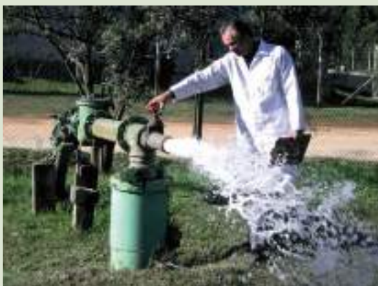
Poços tubulares da SANEPAR no aquífero karst. Água mineral de qualidade para a sociedade.
