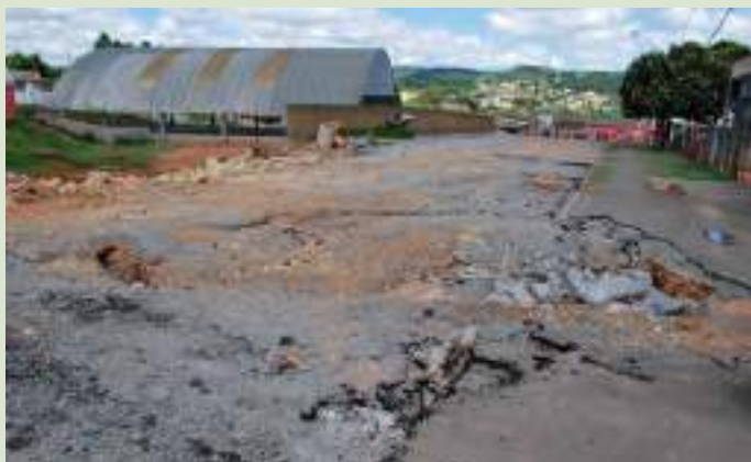
Afundamento cárstico em Almirante Tamandaré em 2011, provocando a interdição temporária de uma rua.
