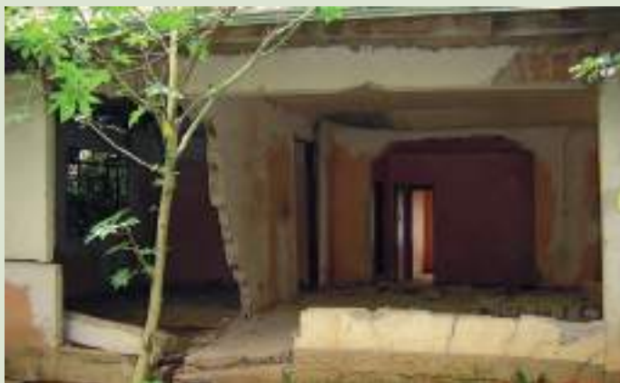
Destruição de uma casa em Almirante Tamandaré causada por afundamentos cársticos. Foto: arquivo MINEROPAR
