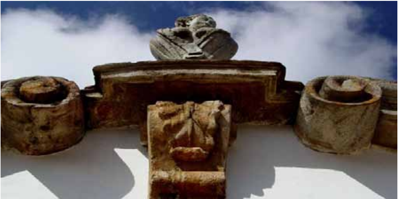
Chafariz do Alto da cruz de quartzito e busto de pedra sabão, cuja autoria é atribuída a Aleijadinho
